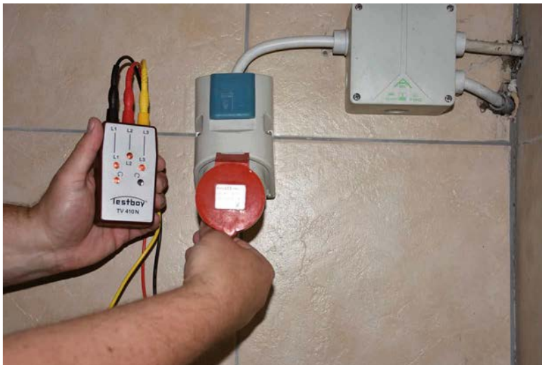
Bei dieser Messung wurde Linkslauf festgestellt. Die Drehrichtung ist also zu ändern.
